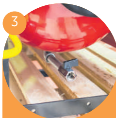
Prolonged purge/ purge prolongée
